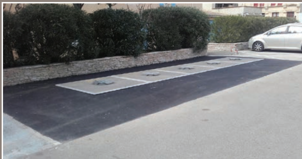
Début des travaux du lotissement «les Roussanes» sur le Chemin dit de Moreau.
